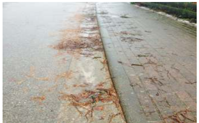
Tagelang, manchmal Wochenlang nicht gereinigt. Zwangsläufig landet alles im Regenwasserkanal.
